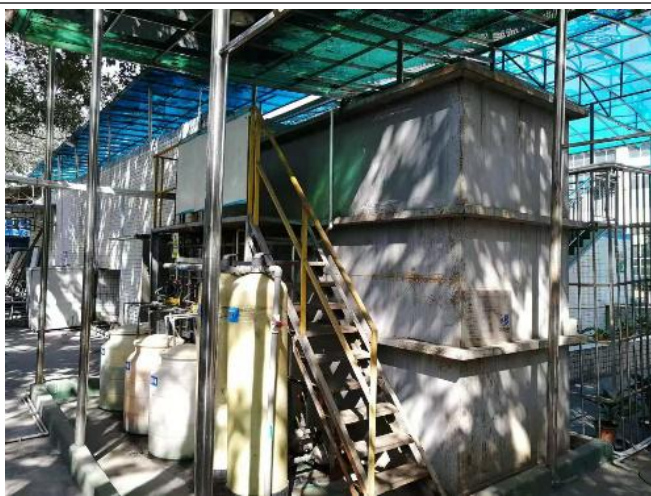
废水处理设备
