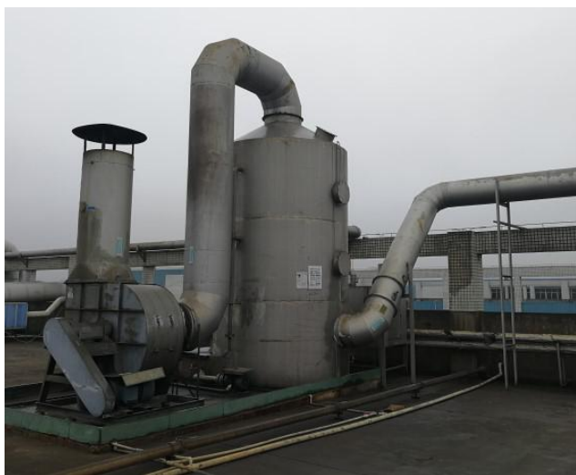
窑炉尾气处理的喷淋装置
