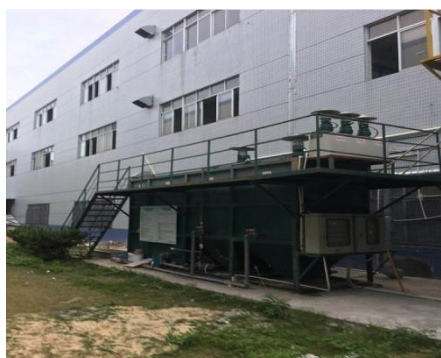
生产废水处理设施
