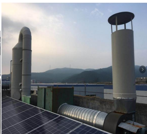
VOCs 处理设施
