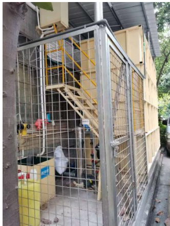
废水处理设施
