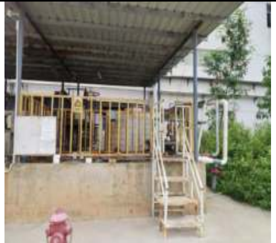
废水预处理设施
