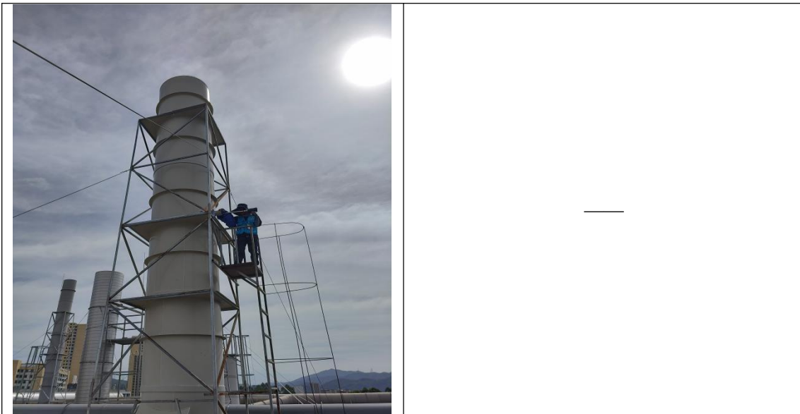
废气处理设施
